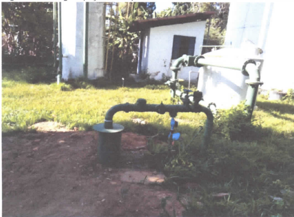
Figura 15 - Vista geral poço tubular profundo – PTP01 do Povoado Vila Tocantins
