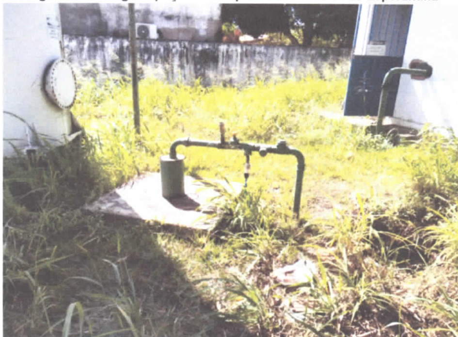
Figura 1 - Vista geral poço tubular profundo – PTP01 de Esperantina
