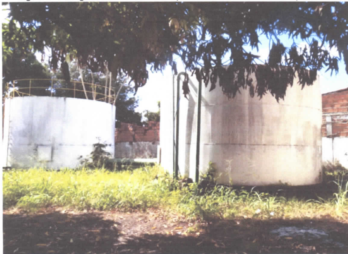
Figura 5 - Vista geral dos reservatórios apoiados RAP01 e RAP02 de Esperantina
