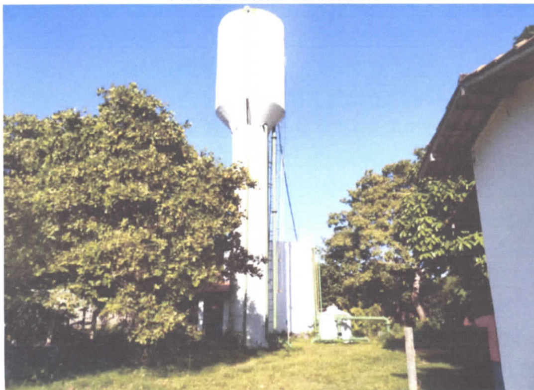
Figura 14 - Vista geral reservatório elevado e apoiado, escritório e poço tubular profundo – PTP01 do Povoado Vila Tocantins
