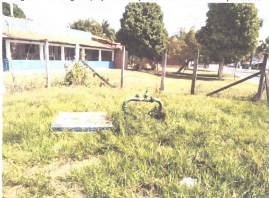
Figura 2 - Vista geral poço tubular profundo – PTP04 de Esperantina
