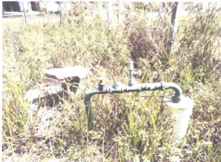
Figura 24 - Vista geral do poço tubular profundo do Povoado Pedra Grande
