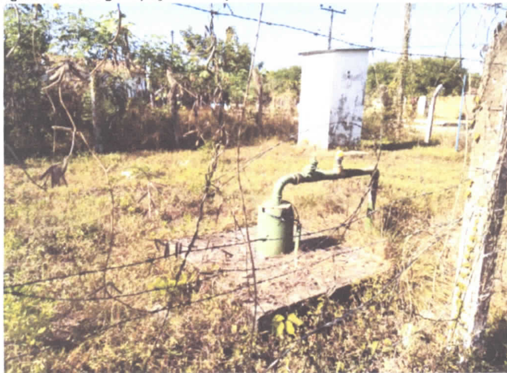
Figura 16 - Vista geral poço tubular profundo – PTP02 do Povoado Vila Tocantins
