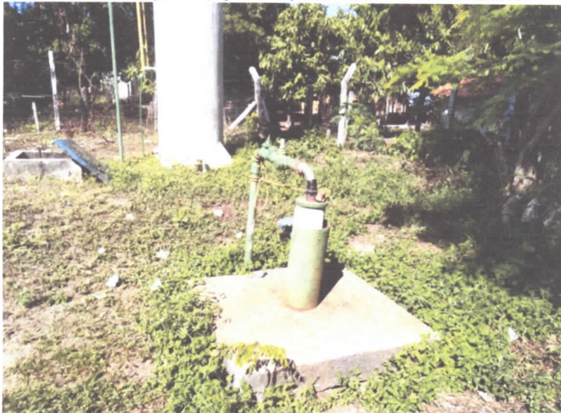
Figura 22 - Vista geral do poço tubular profundo do Povoado São Francisco
