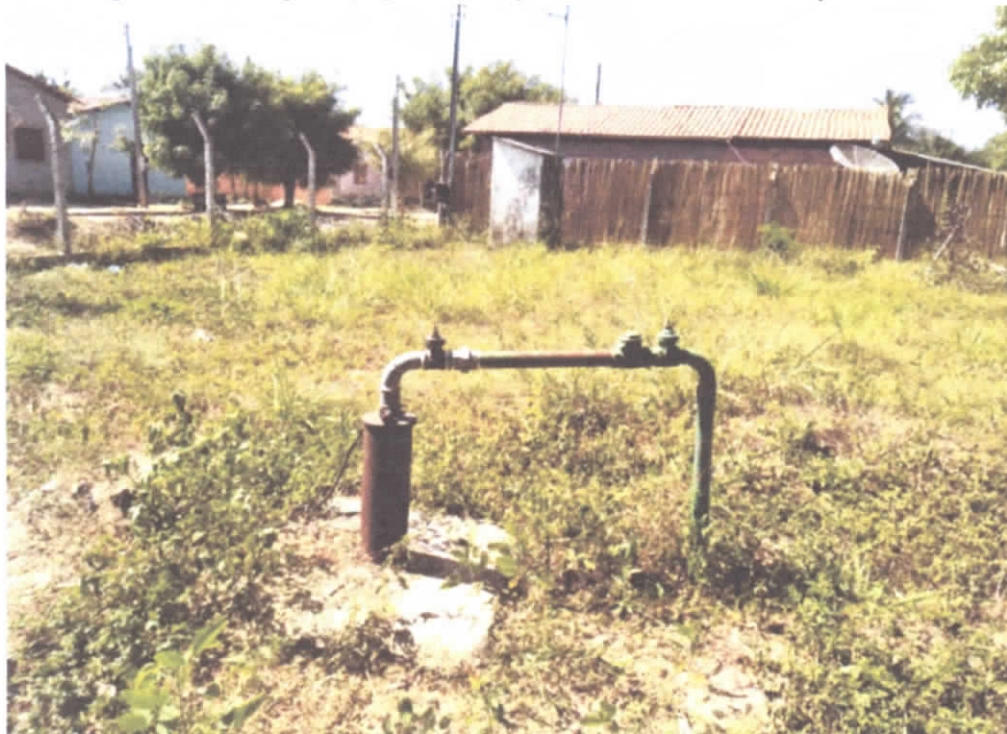
Figura 3 - Vista geral poço tubular profundo – PTP05 de Esperantina
