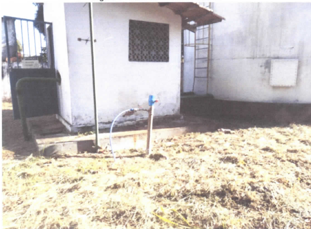
Figura 4 - Vista do dosador de cloro
