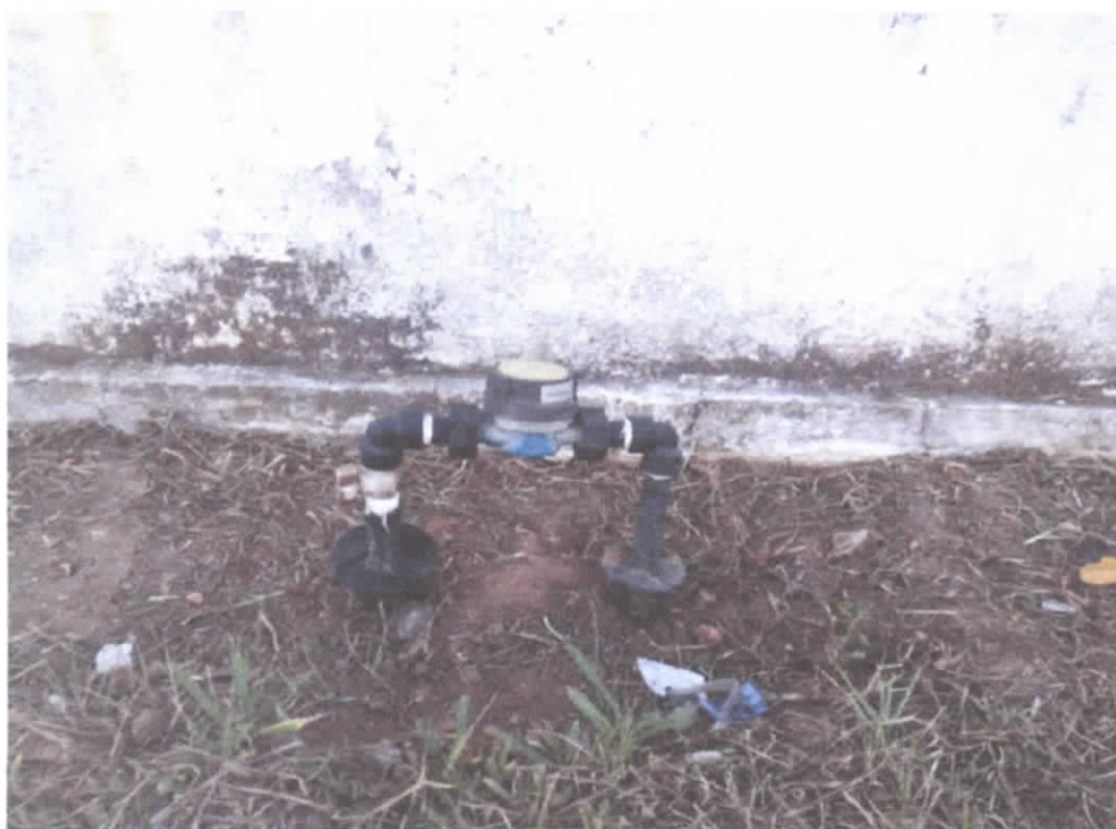
Figura 7 - Hidrômetro instalado no perímetro urbano de Esperantina
